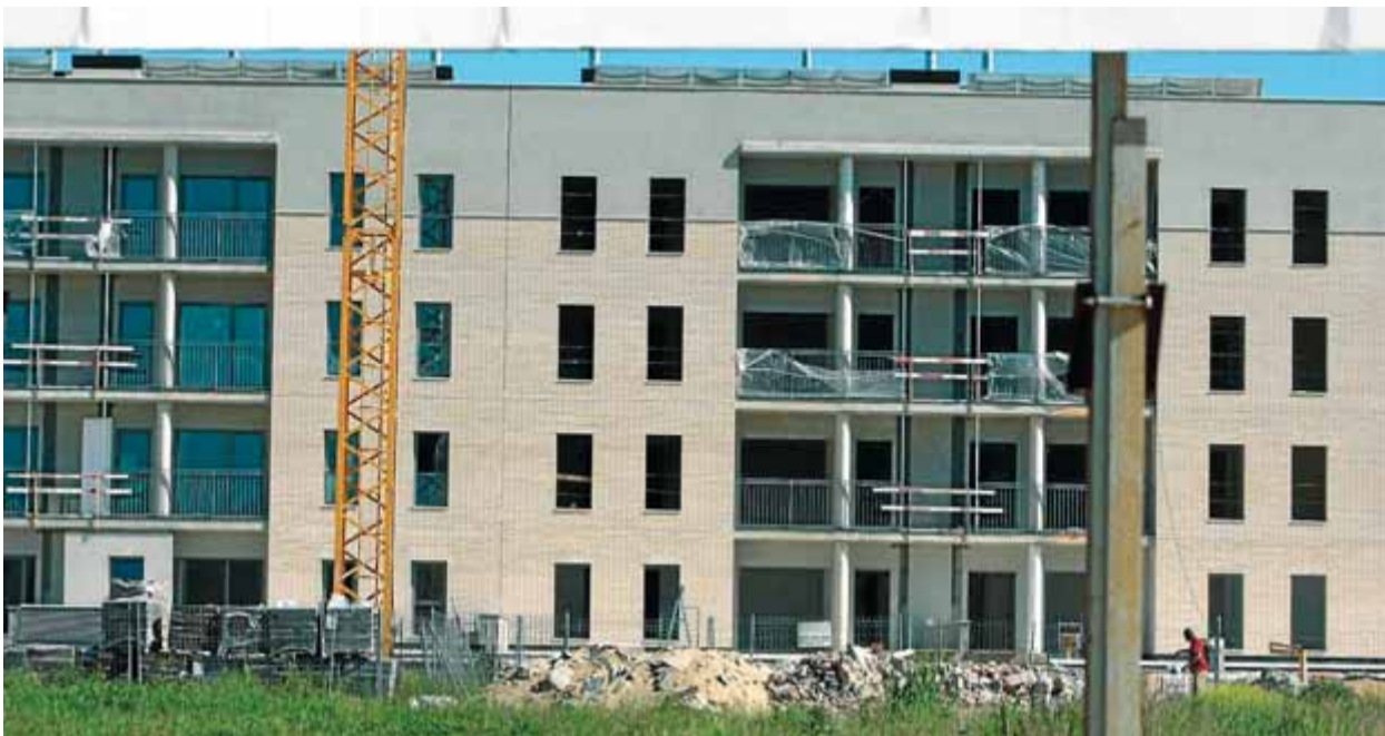
Una promoció d'habitatges en construcció al municipi de Salt ■ EL PUNT AVUI
